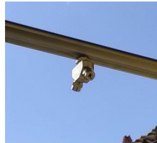
Figura 3 Tubazione Etea Mist LP2 con giunto di connessione tra ugello e tubo, UNI CEN/TS 14972;
